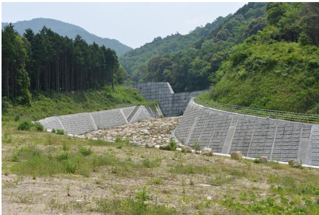
砂防工事後の土石流災害のあった溪流の上流部（真尾）
